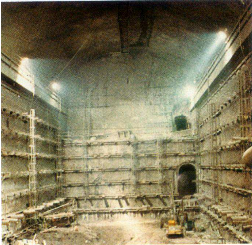
Impianto idroelettrico Fortuna - Panama RODIO - 1984
