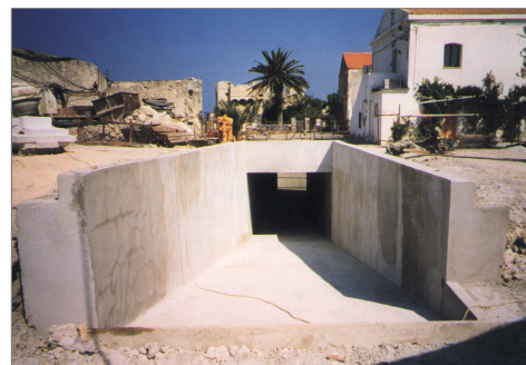
Le rampe di uscita dei trattori, prima delle opere di completamento architettonico.
